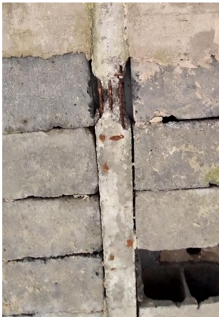
zdj. 12 Uszkodzona belka stropodachu
