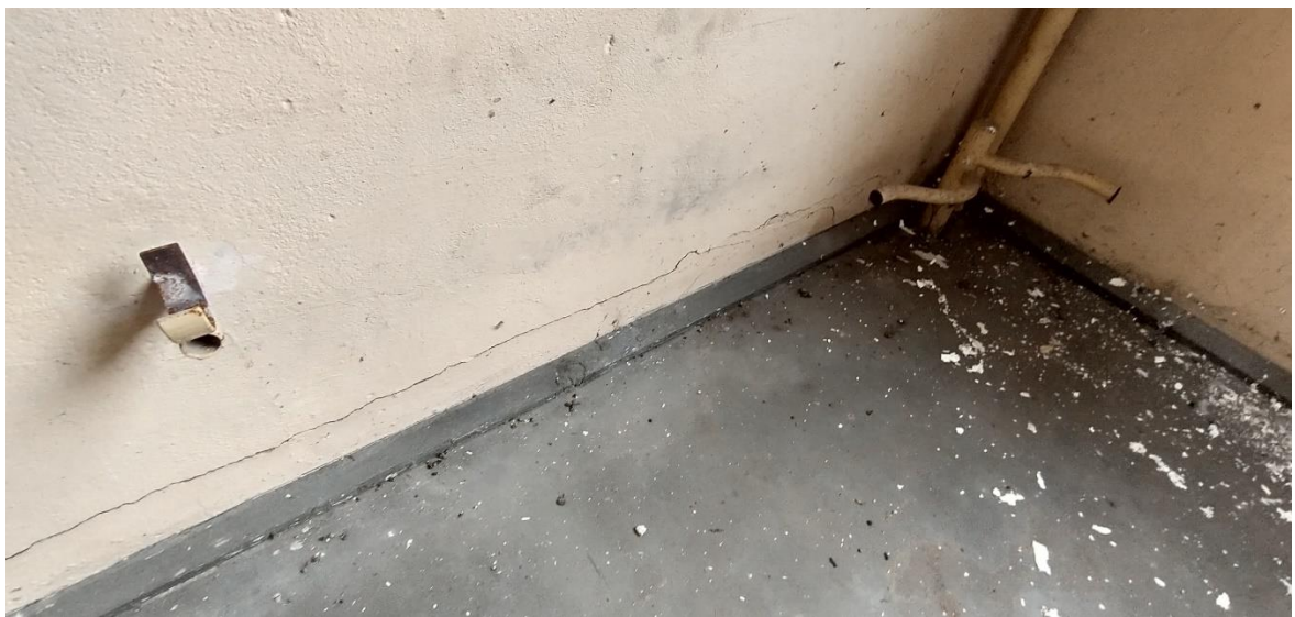
zdj. 6 Widok zarysowania ściany piętra bezpośrednio nad podciągami w osi 1
