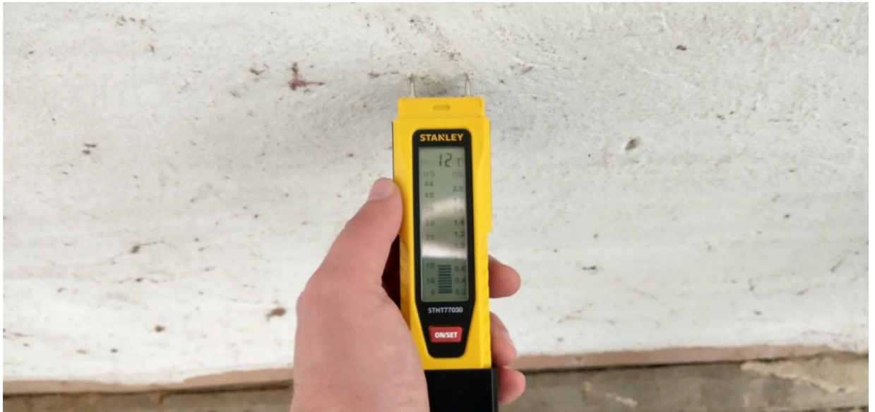
zdj. 15 Nieznaczne zawilgocenia ścian parteru w obrębie klatki schodowej
