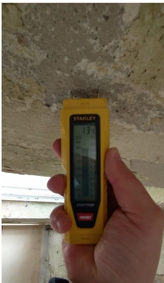
zdj. 1 Zawilgocony filarków
