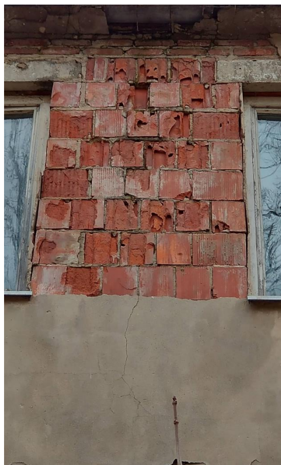
zdj. 2 Uszkodzony filarek
