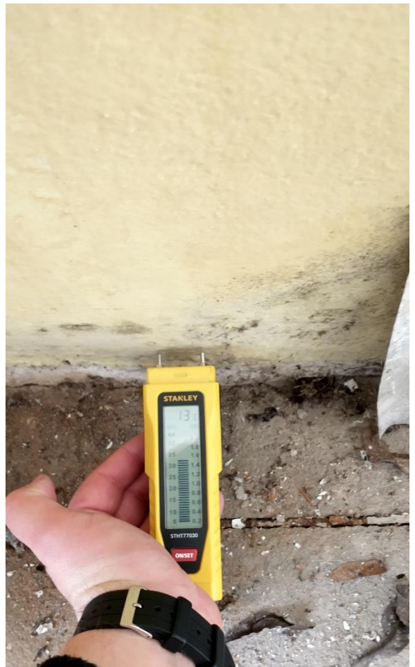
zdj. 4 Wilgotność ściany pom 1.15
