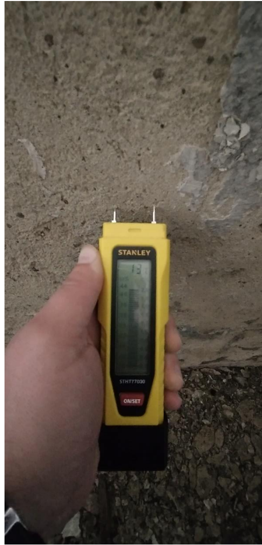
zdj. 9 Zawilgocony tynk ścian piwni
