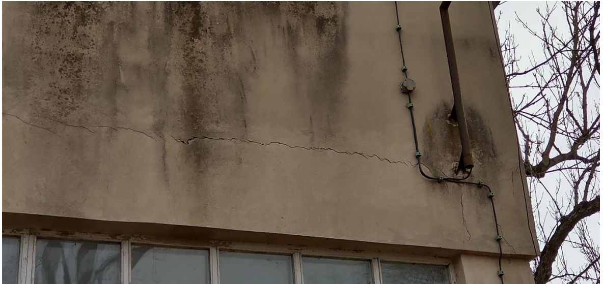
zdj. 7 Widok zarysowania ściany piętra bezpośrednio nad podciągami w osi H
