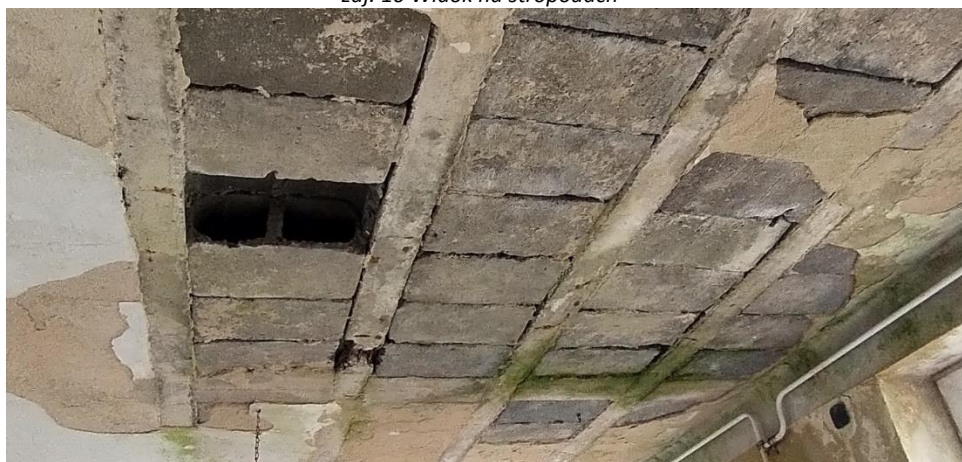
zdj. 11 Uszkodzony stropodach
