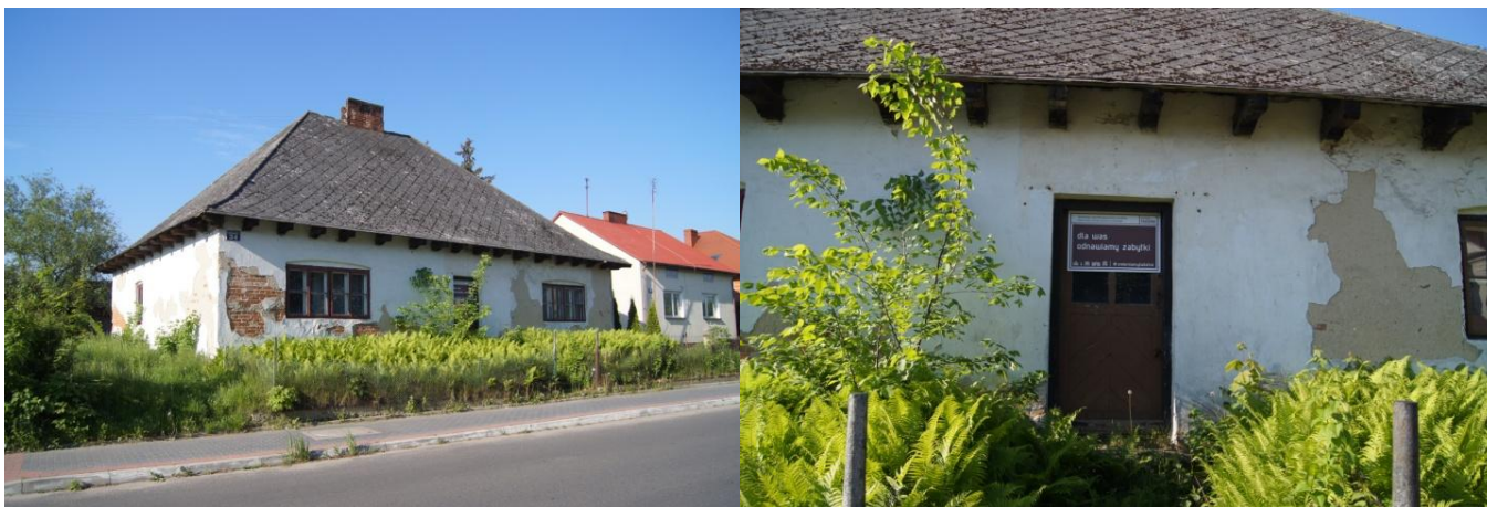
Dawna organistówka w Rzeszycy wpisana do rejestru zabytków wymagająca kontynuacji prowadzonych prac remontowych
